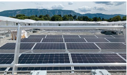
La toiture de la cage de scène avec ses rangées de capteurs photovoltaïques qui produiront du courant en toute discrétion
