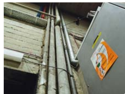
Après 40 ans de bons et loyaux services, la tuyauterie est en bout de course
