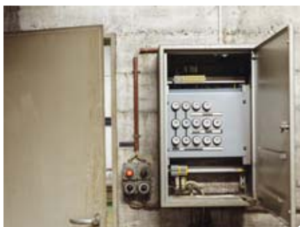
Les installations techniques sont obsolètes
