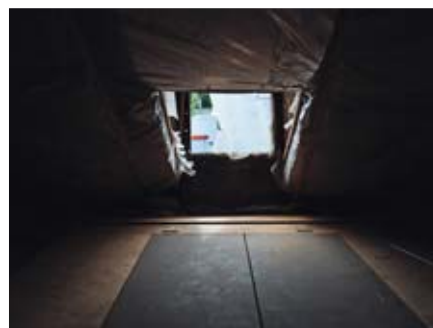
A certains endroits, du plastique a remplacé les fenêtres
