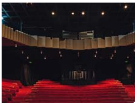
Au-dessus de la Salle François-Simon, les plaques d'amiante servant à améliorer l'acoustique sont omniprésentes
